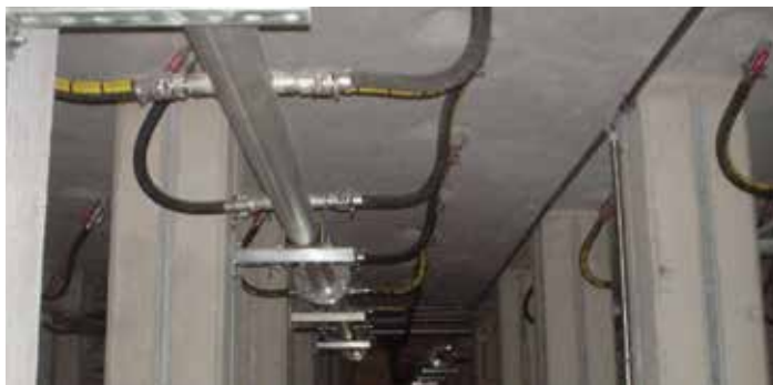
Technikraum unter dem Gärbehälter
