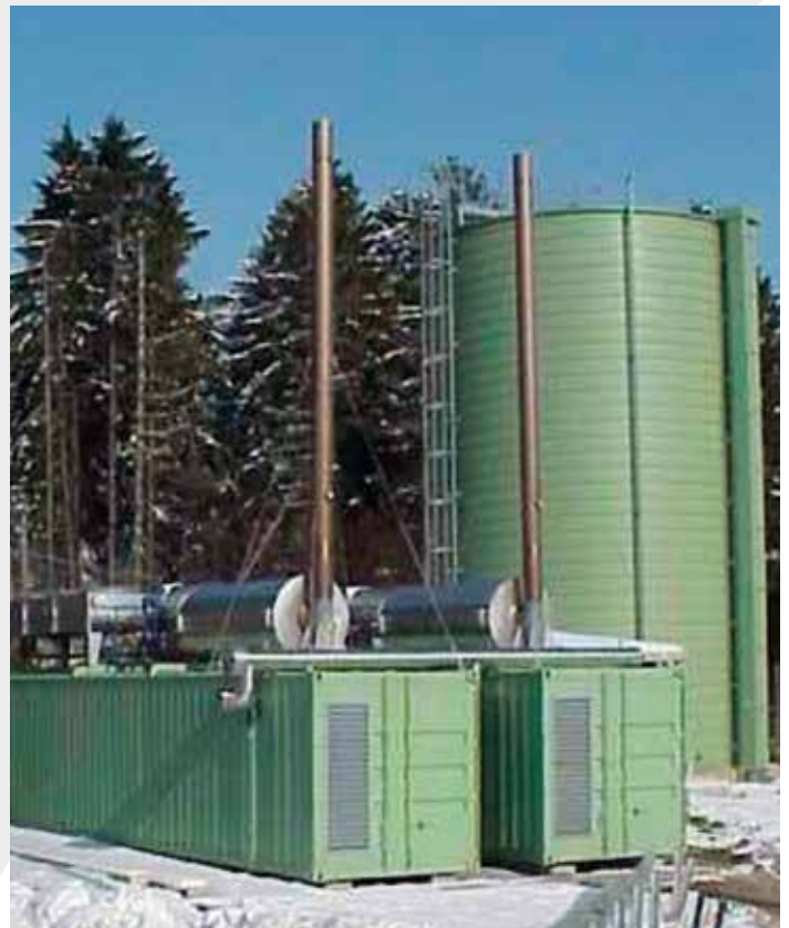
Biogasnutzung mittels BHKW in Containerbauweise mit Fernwärmeauskopplung
